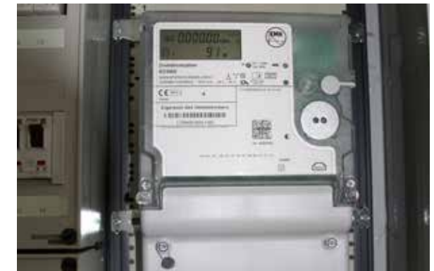
Moderne Messeinrichtung mit Kommunikationsschnittstelle
